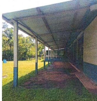
Foto 2: Falta de piso de concreto en el corredor.
