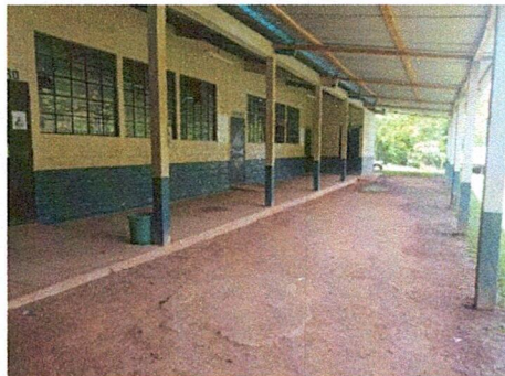
Foto1: Vista panorámica estado actual de la pintura del edificio y la ventana de vidrio y falta de ventilación.
