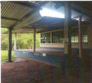
Foto 5: Piso de tierra y gotea el escenario.
